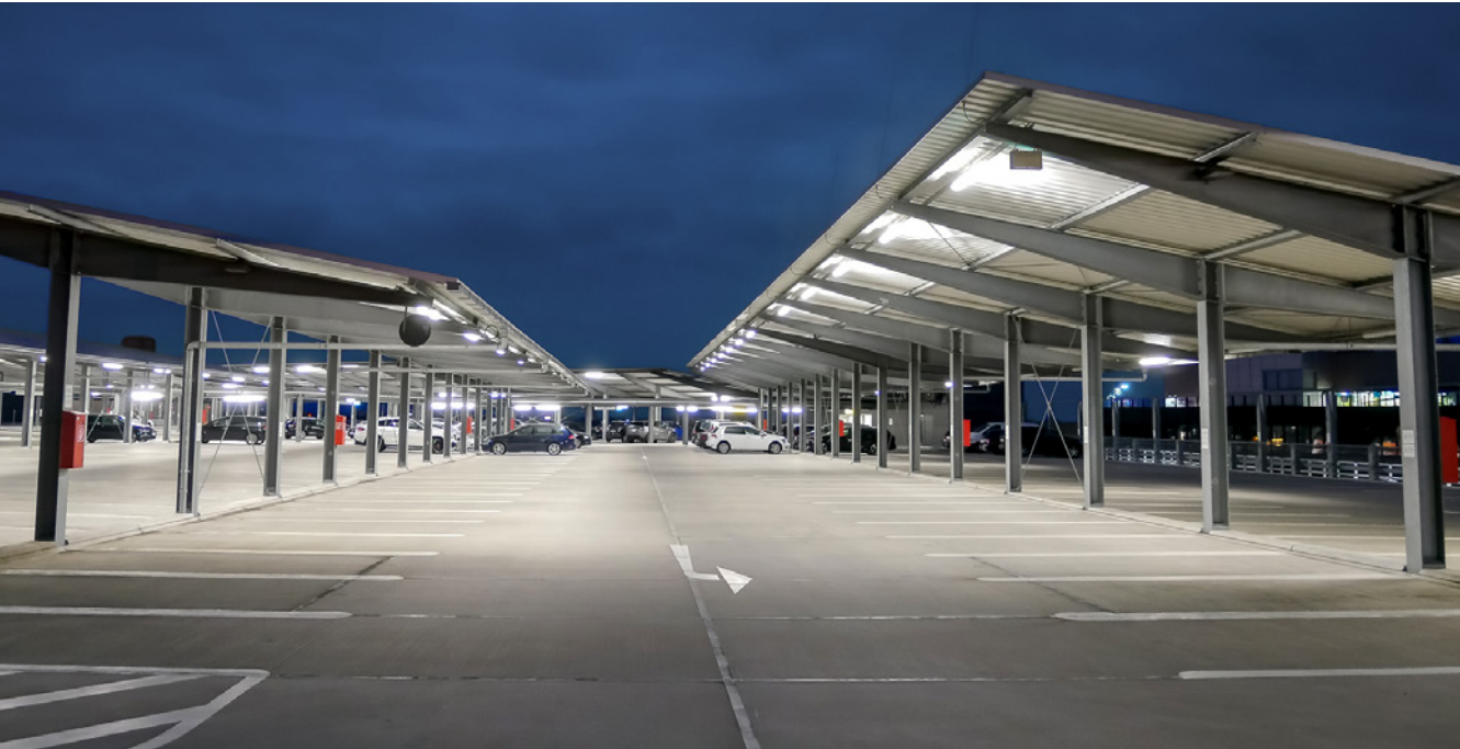
Bedarfsgerechte Steuerung der Leuchten auf dem Parkdeck
